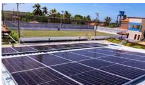
Painéis Solares Instalados na Sede Social e Recreativa do Sindjus-MA, na Grande Ilha
